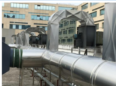
楼顶收集管道
