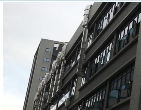
车间至楼顶收集管道
